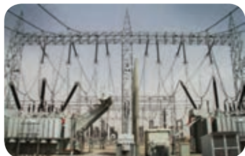
شکل ۱۷- پست انتقال برق
